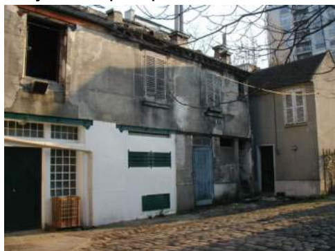
Impasse du 26 rue de Paris – immeuble insalubre
